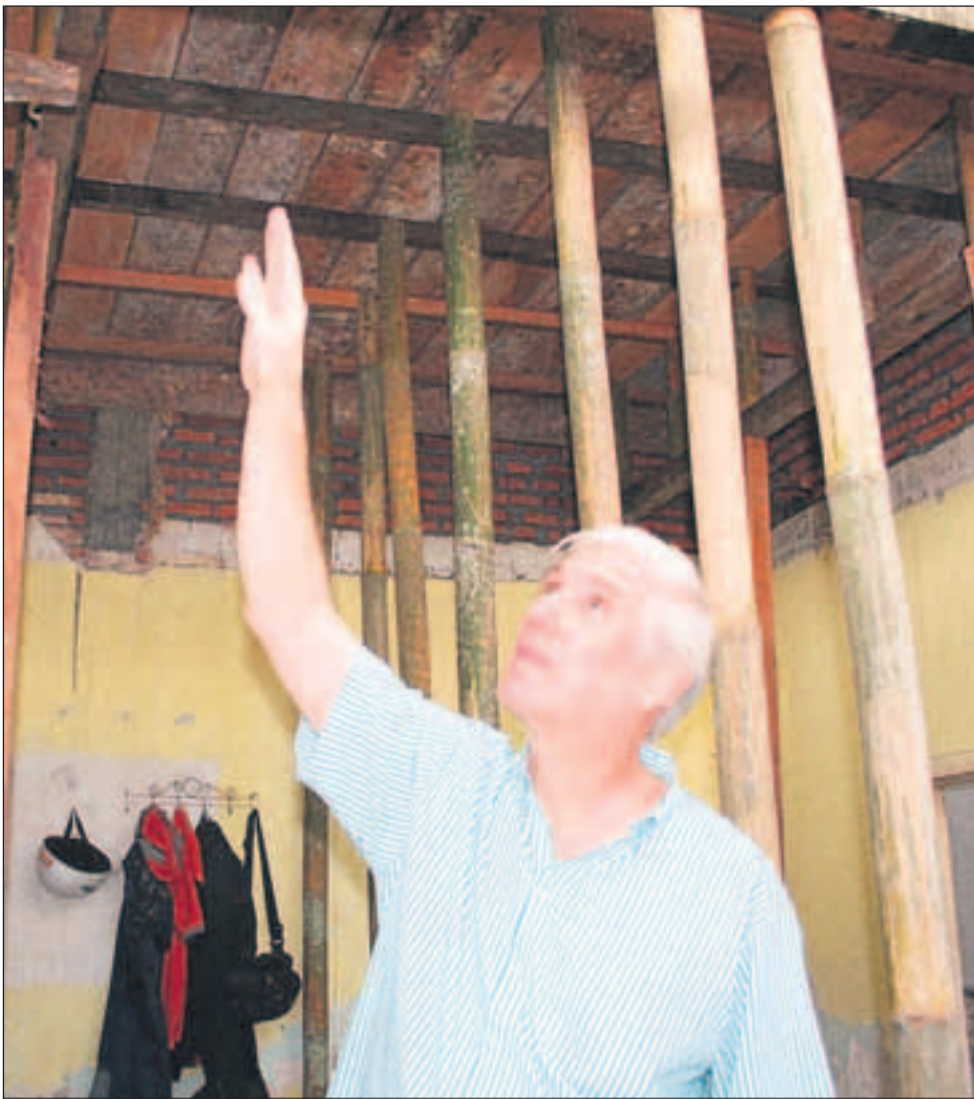
Pim Vroegop inspecteert het dak van het kantoor in Sukung, dat onlangs gerenoveerd is.
